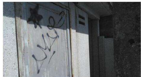
Les habitants de la place ont déjà signalé cet état de fait à plusieurs reprises. Photo Jean-Marc Perrodet
